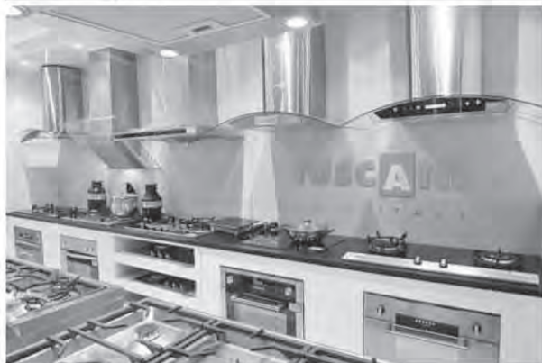
具有隔烟设备的先进科技化厨房。
